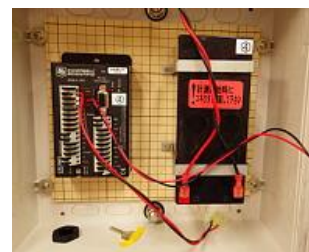
内部は、C-CR300 と 鉛蓄電池のみと シンプルな構造
